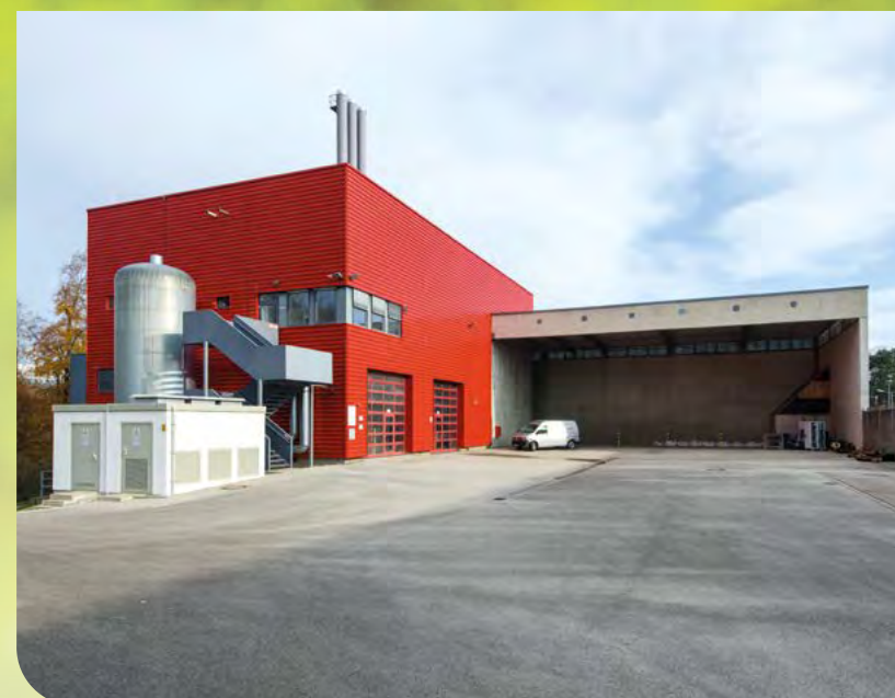
Biogas-Blockheizkraftwerk und Fernwärmenetz in Kaufbeuren
